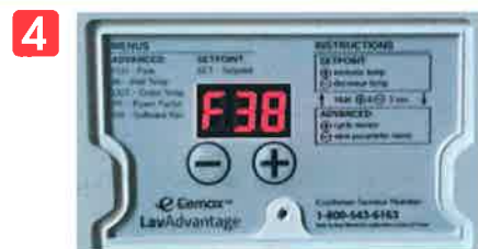
Fはエラー表示 例F38 設定温度に対して流量が多すぎる場合に表示され、出湯バルブを絞る必要がある
